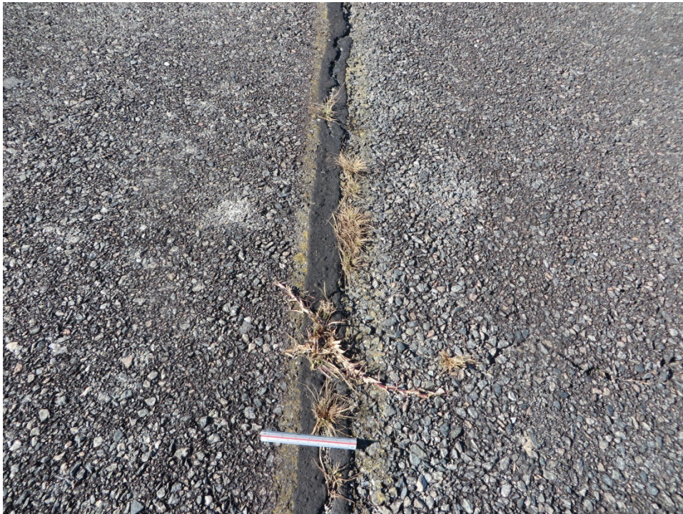
TAHO-10. L&T Cracking (Sample Unit No. 03).
